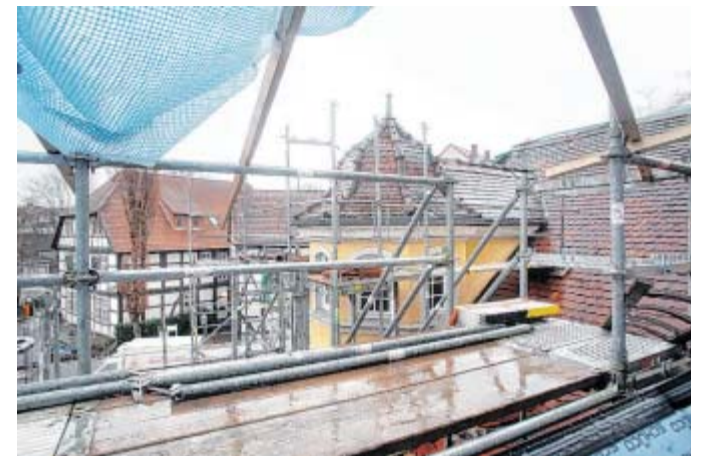
Offenes Dach: Sturmböen haben den Schutz von den Lichtbändern gerissen. Die Dachdecker mussten ausrücken.
