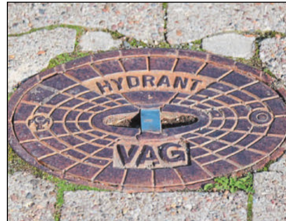
Weshalb dieser Hydrant an der Salzuffer Straße trocken blieb, wird derzeit geklärt.
