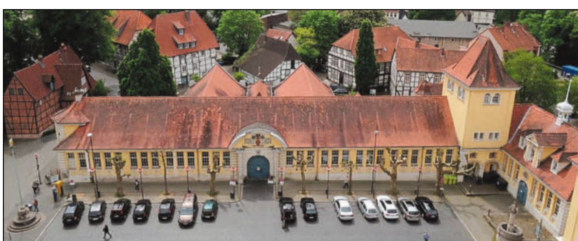
Ein gepflegtes Äußeres wertet den Gesamteindruck auf: Wind und Wetter hatten dem Markthallen-Dach eine hässliche Patina verliehen. Die schwarzen Flecken ließen das historische Gebäude in keinem guten
