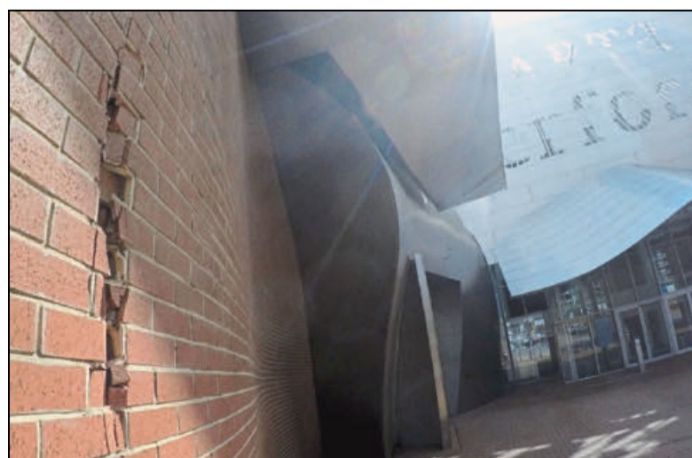
Nein, bei dem Backstein-Riss handelt es sich nicht um Kunst. Ein Hubwagen hat die Fassade beschädigt. Fotos: Moritz Winde
