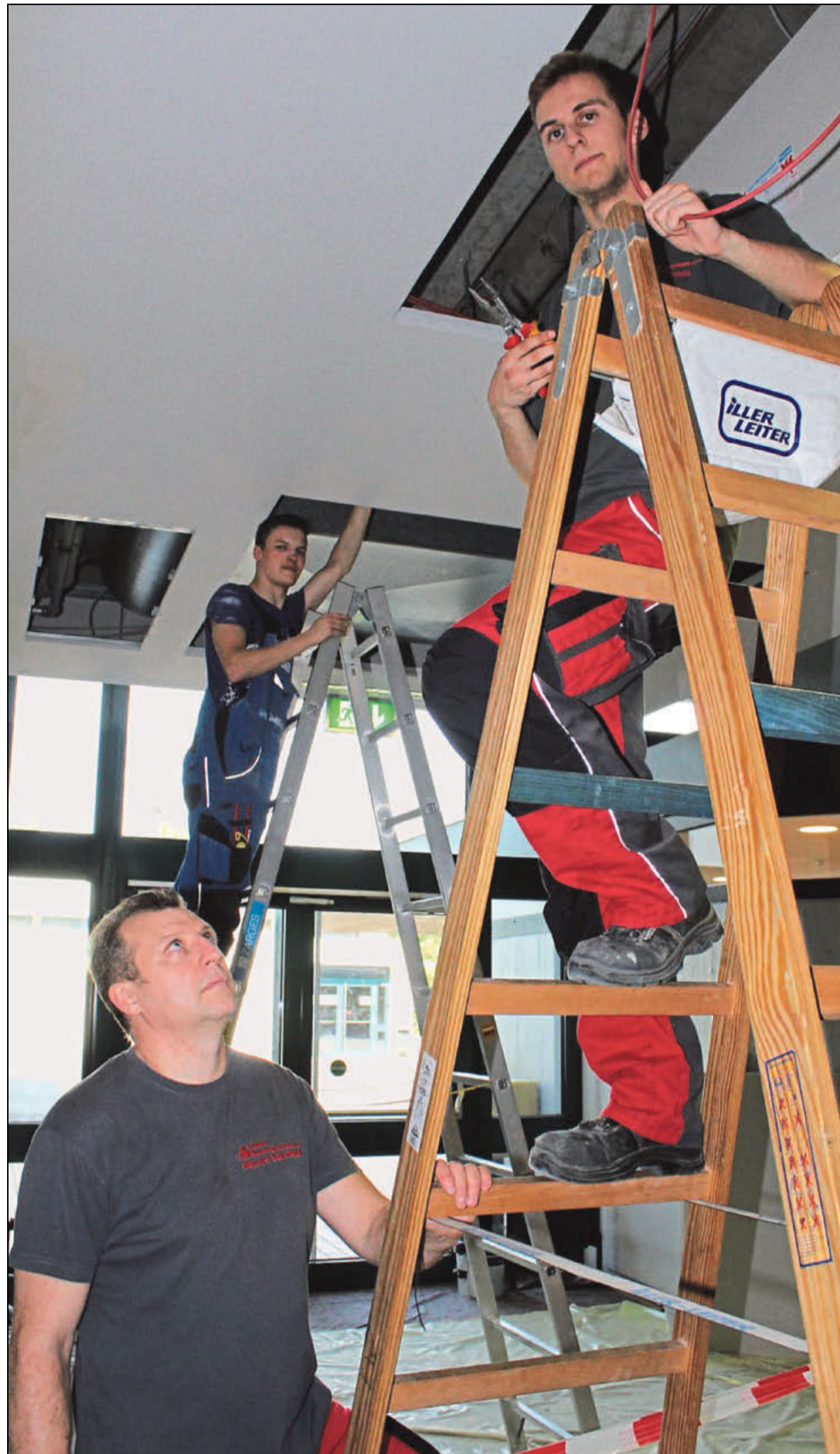
Eduard Sabelfeld schaut, ob Azubi Benedikt Fratzke Lingner. Sie sind für die Elektronik auf der Baustelle alles richtig macht; im Hintergrund Azubi Julian des Siemens-Kollegs zuständig. Fotos: Hillebrenner
